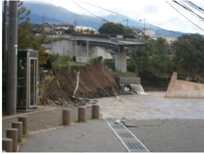
大屋駅～田中駅間白鳥 B0 崩落
