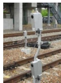
踏切障害物検知装置
