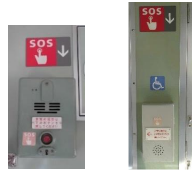
非常通報装置 1 非常通報装置 2
