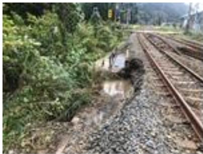
黒姫駅～妙高高原駅間道床流出箇所
